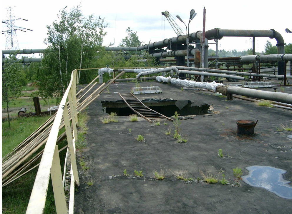
Rys. 2. Widok przekrycia po awarii.
