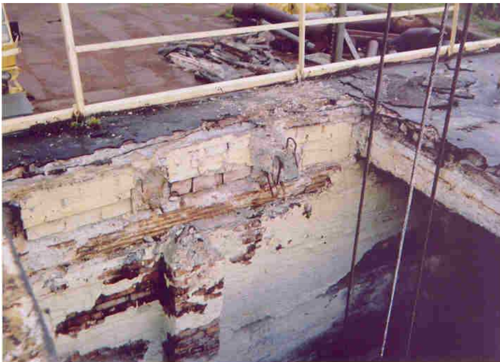
Rys. 3. Uszkodzenia elementów konstrukcyjnych w miejscu zawalonego stropu.
