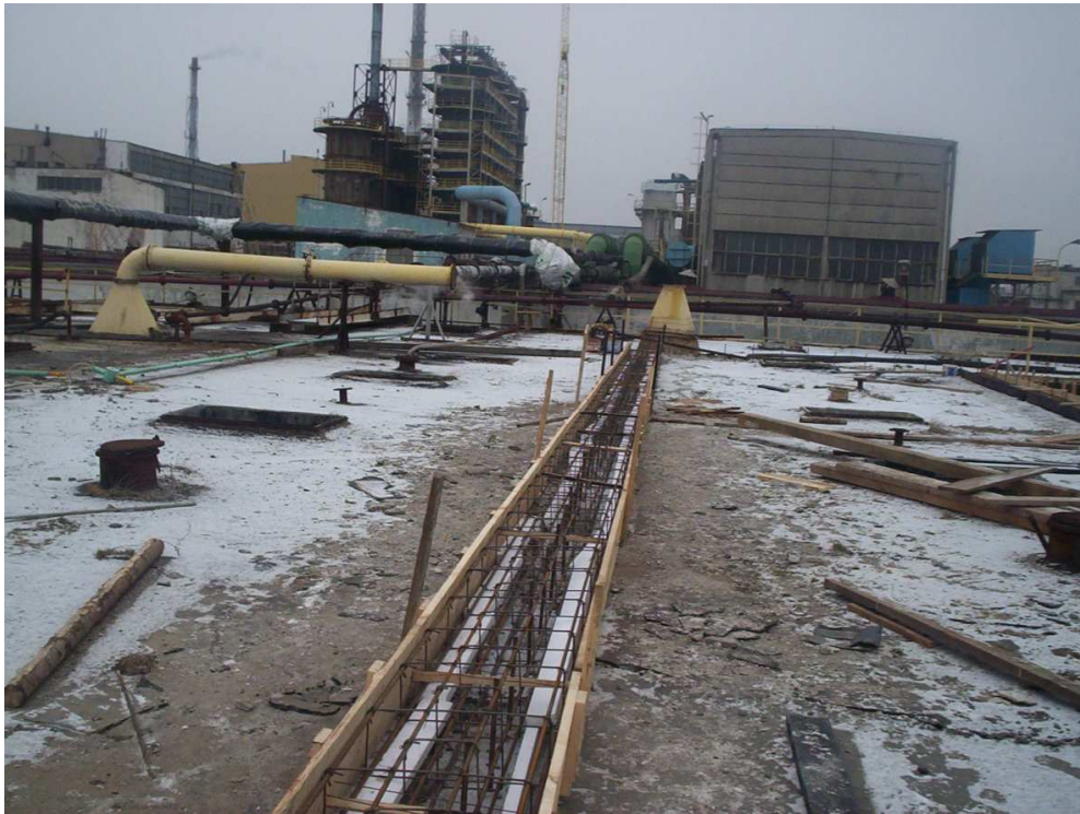
Rys. 6. Wykonywanie nowego żelbetowego wieńca wzmocniającego stanowiącego oparcie dla przekrycia z płyt panwiowych.
