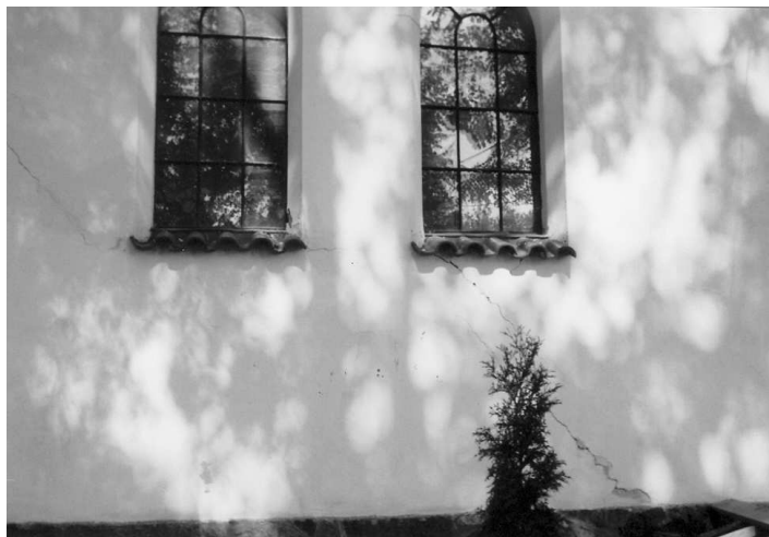
Rys.5 Ukośna część zarysowania ściany zewnętrznej kościoła
