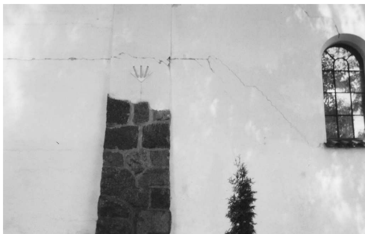
Rys.6 Pozioma część zarysowania ściany zewnętrznej kościoła
