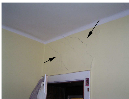
Rys. 4. Zarysowania na podłużnej ścianie nośno-usztywniającej na I p. z zablokowaniem drzwi, powstałe w trakcie prac w strefie sklepu na parterze
