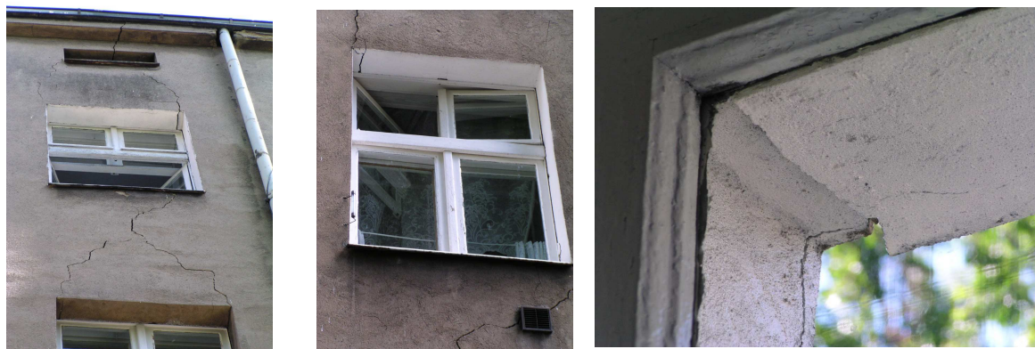
Rys. 6-8. Przykładowe zarysowania od podwórza w części północnej
