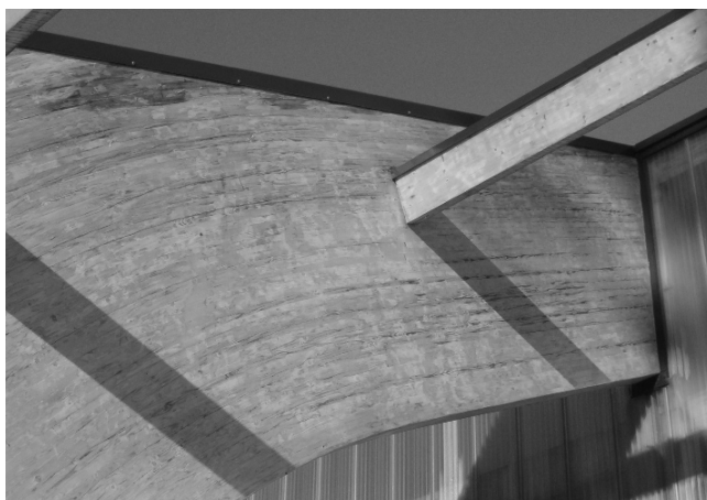
Rys 6. Przykłady korozji powierzchniowej dźwigarów w osiach 11-18
