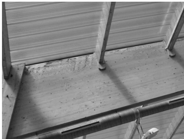
Rys 8. Lokalne uszkodzenia powłoki ochronnej dźwigarów wewnątrz hali
