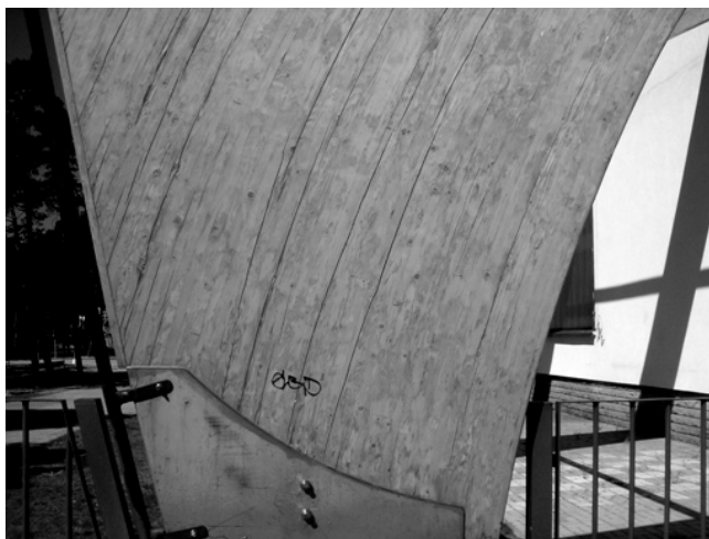
Rys 5. Pęknięcia podłużne dźwigara D-1, w osi 20
