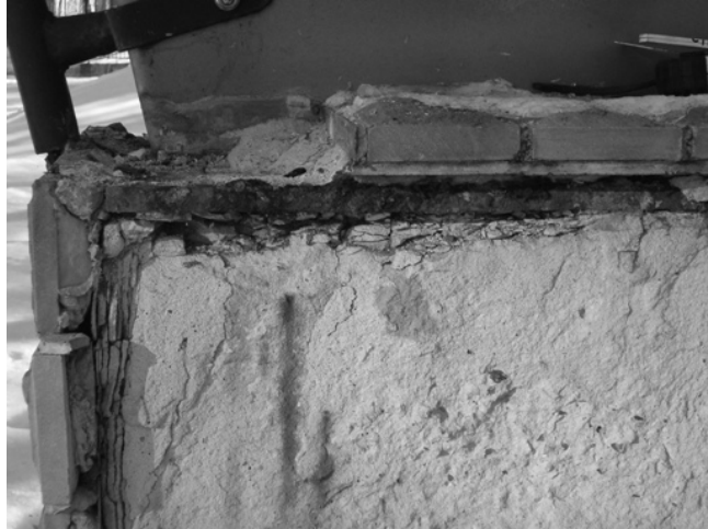
Rys 7. Uszkodzenia cokołów żelbetowych
