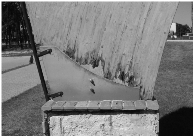
Rys 4. Uszkodzenie dźwigara D-1, w osi 9 od strony wschodniej
