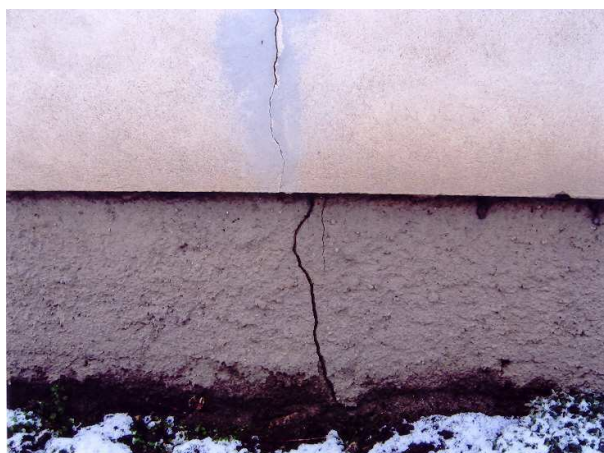
Rys. 5. Spękania widoczne na ścianie zewnętrznej
