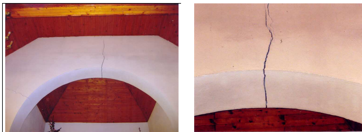
Rys. 7. Widok pęknięć i zarysowań na ścianie poprzecznej
