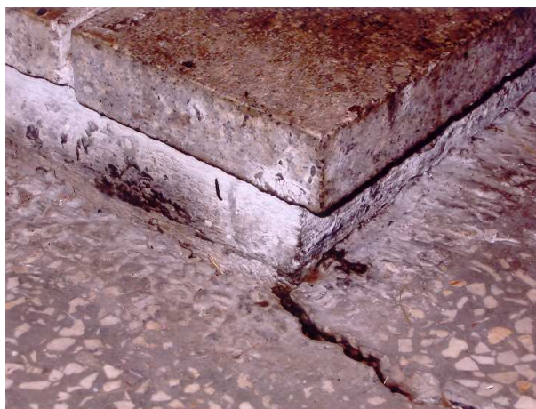
Rys. 8. Spękana posadzka z lastriko (widoczne przemieszczenie pionowe)
