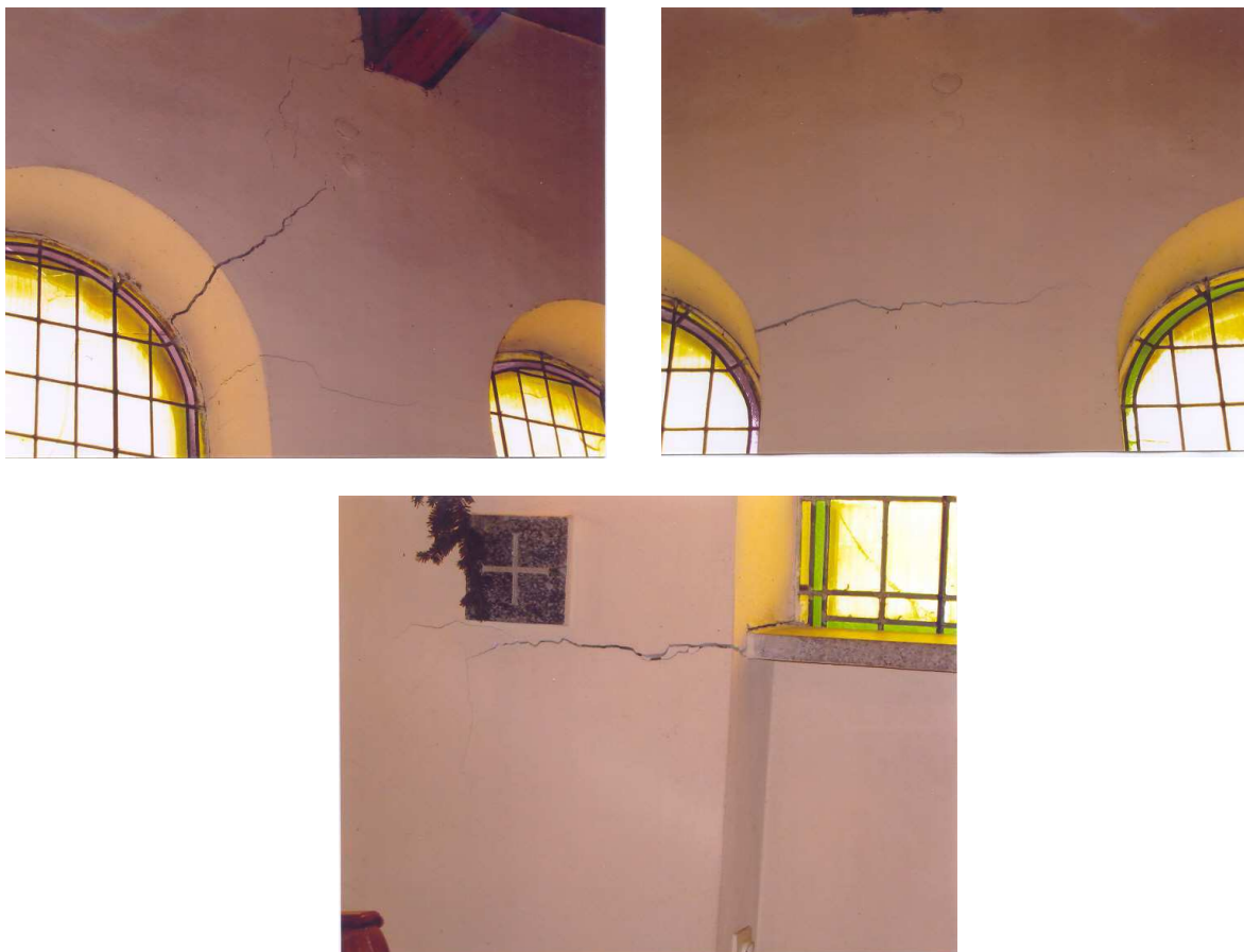
Rys. 6. Widok spękań na wewnętrznej powierzchni ścian zewnętrznych.
