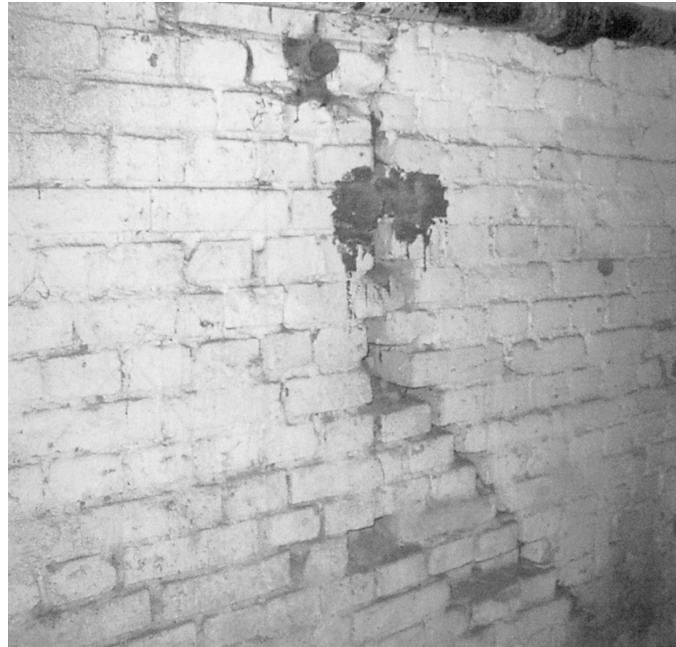
Rys.3. Szczelina w ścianie nośnej wewnętrznej (piwnica) [2].
