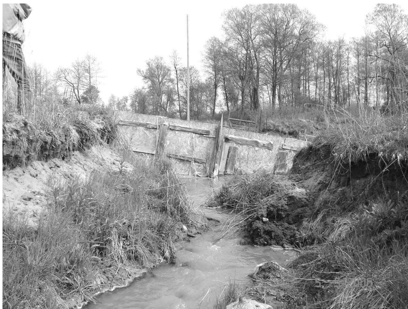
Rys.6. Strumień odprowadzający wody z głównego zapadliska.
