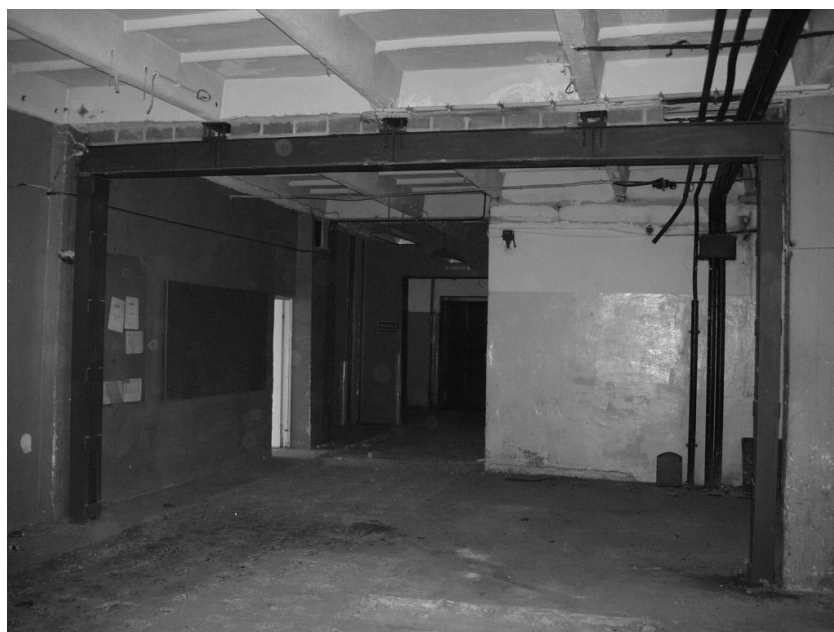
Rys.5. Podparcie stalową ramą podciągu z przerwanymi na skutek korozji drutami zbrojenia sprężającego
