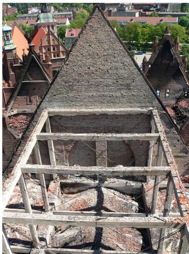
Rys.4. Żelbetowy szkielet ramy przestrzennej nad sklepieniami nawy środkowej korpusu. (stan po pożarowy)
