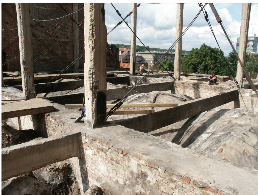
Rys. 3. Widok fragmentu odgruzowanych sklepień oraz belek rusztu żelbetowego
