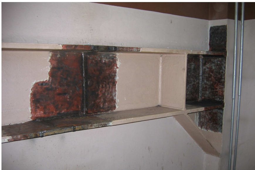
Rys. 2. Styk montażowy w ryglu ramy poprzecznej odsunięty od słupa - wykonany zgodnie z projektem.
