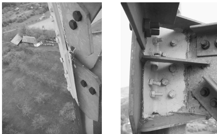
Rys. 5. Luźne łączniki i wygięte trzpienie śrub w styku montażowym
