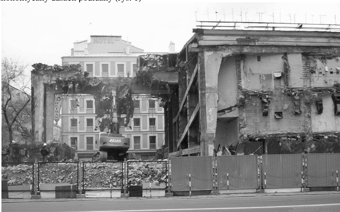
Rys. 2. Burzenie nawy bocznej
