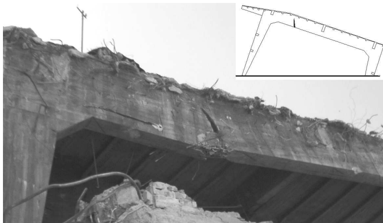
Rys. 7. Zarysowanie rygli w końcowym procesie „kładzenia” ram
