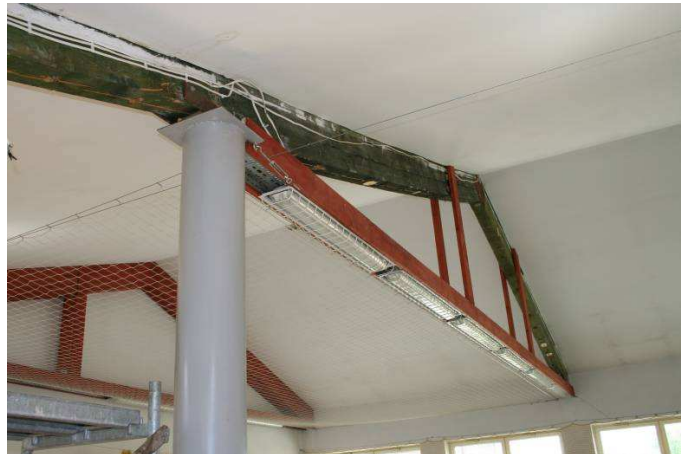
Rys. 2. Obserwowalne gołym okiem ugięcia dźwigarów nad salą
