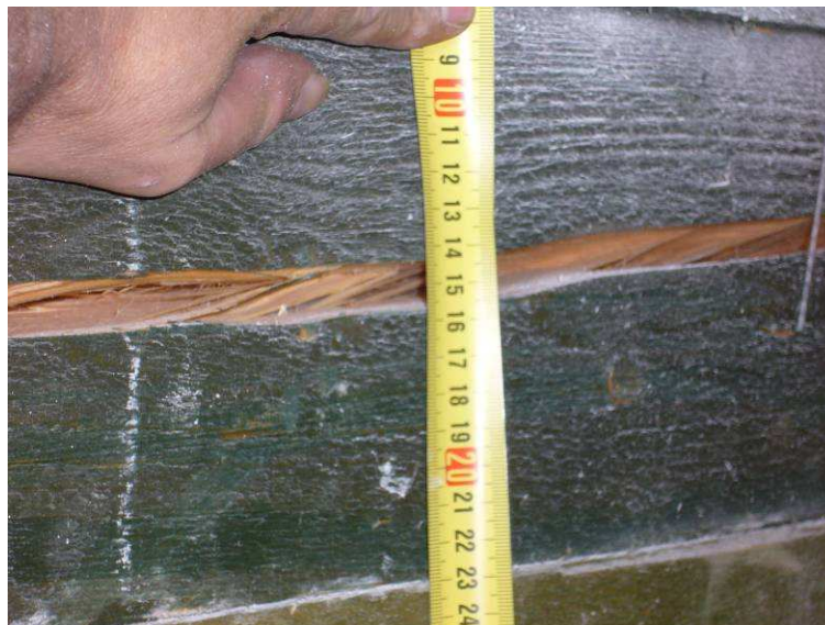
Rys. 3. Pęknięcie drewna belki dźwigara
