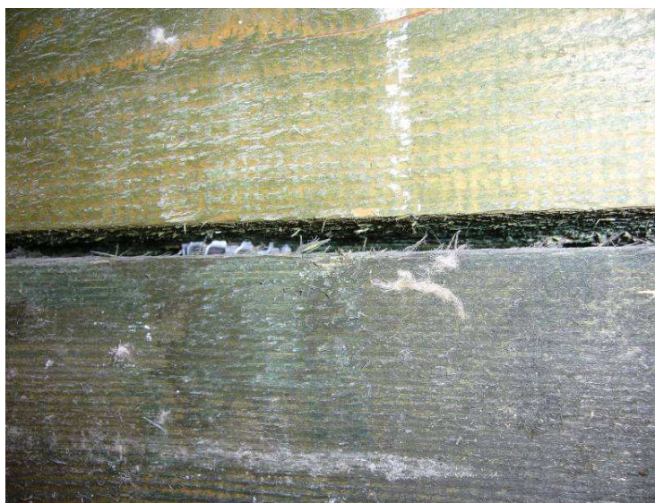
Rys. 5. Znaczne rozwarcie belek dźwigara, widoczne wysunięte zęby pierścienia z drewnianej belki
