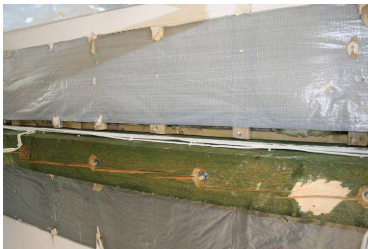
Rys. 4. Pęknięcia drewna oraz przerwa pomiędzy folią a dźwigarem dachowym
