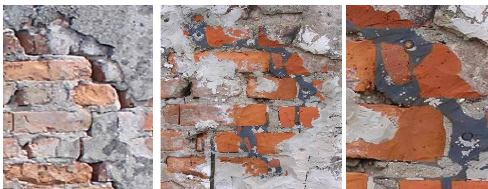
Rys.1. Rozdzielone pęknięciem elementy konstrukcyjne sklezione specjalnie dobraną masą polimerową.
