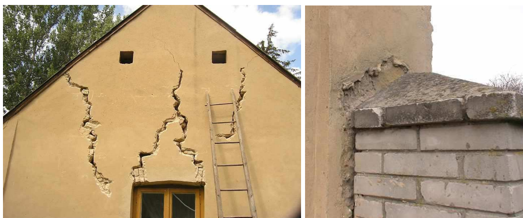
Rys.3. Uszkodzenia południowej ściany szczytowej przebiegające przez zaprawę łączącą kamienie oraz obraz przemieszczeń słupka bramowego w południowo-wschodnim narożniku budynku
