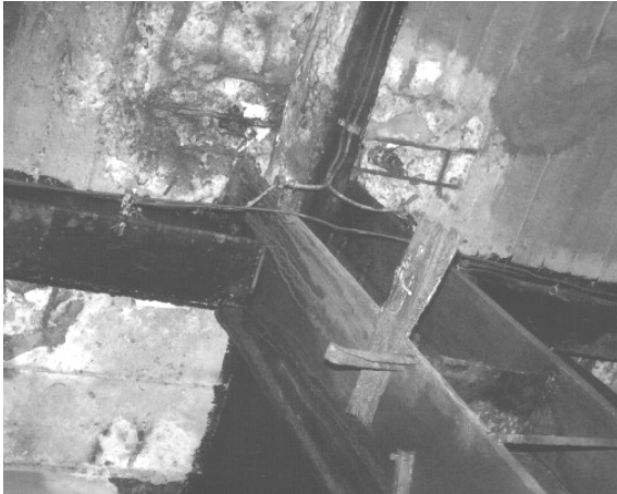
Rys. 2 Korozja stali w węzłach konstrukcji
