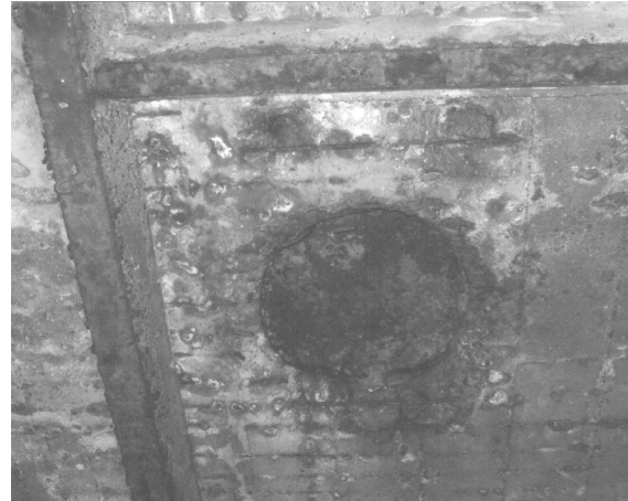
Rys. 3 Korozja zbrojenia w stropach
