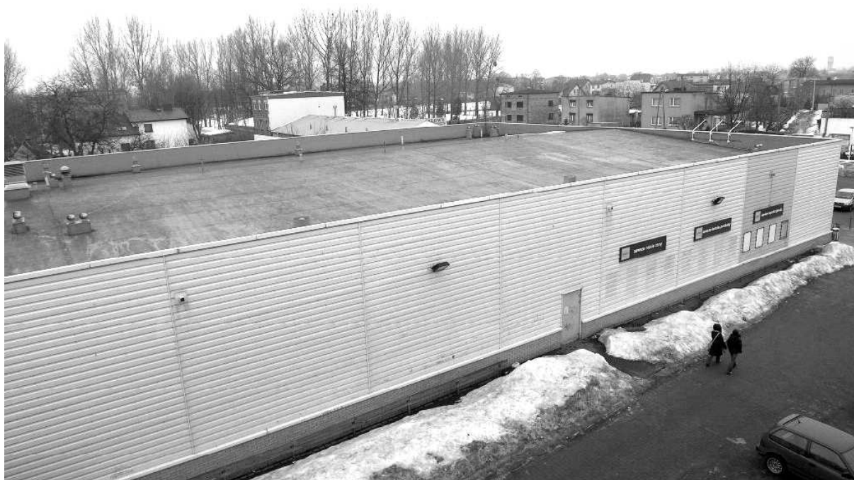
Rys. 1. Widok pawilonu z wyniesionymi ścianami podłużnymi do poziomu kalenicy, tworzącymi efekt „wanny” na dachu. W części attyki, wzdłuż ściany widoczne cztery otwory przelewowe.
