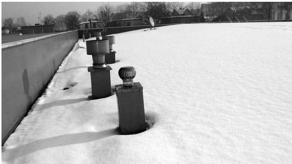
Rys. 2. Zalegający śnieg na dachu z mało skutecznym systemem jego rozmrażania, z przewarstwieniami i zlodowaceniem wokół przewodów wentylacyjnych i odpływu wód opadowych
