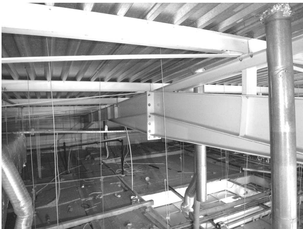
Rys. 6. Konstrukcja ryglu ramy układu nośnego ze wzmocnieniem naroża przy słupie i w obszarze „pozornej kalenicy” ze wzmocnieniem krokwią stalową
