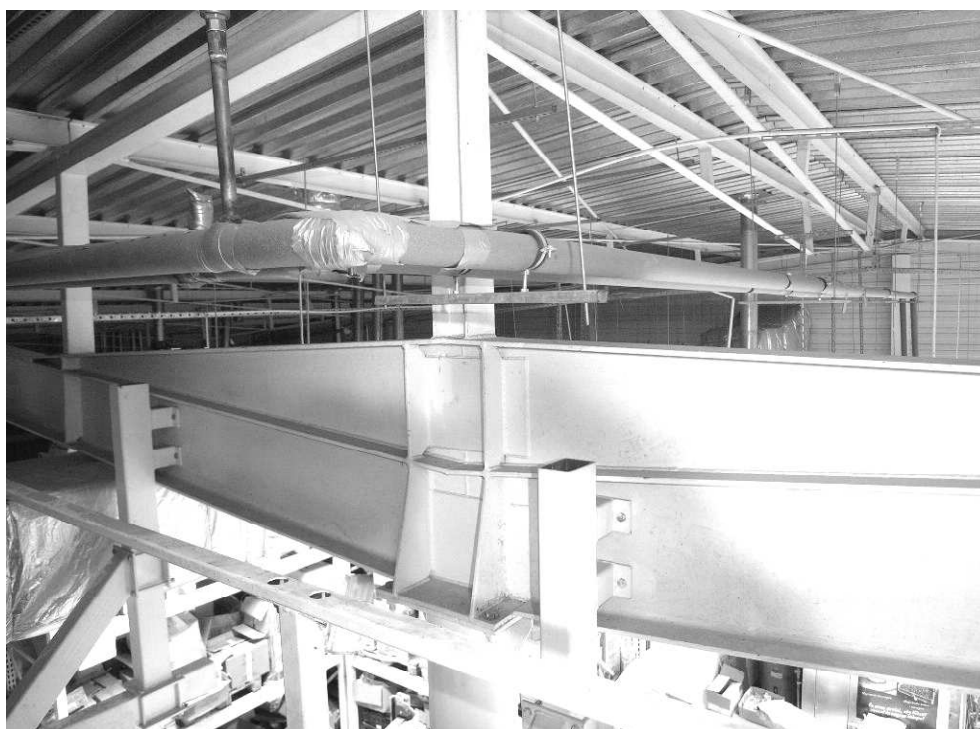
Rys. 7. Wzmocniony węzeł dolny ramy w osi słupa środkowego ze słupkiem podporującym krokiew kształtującą dach dwuspadowy
