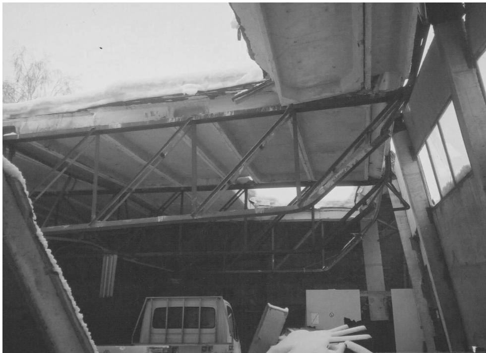
Rys. 3 Obraz konstrukcji hali po katastrofie.
