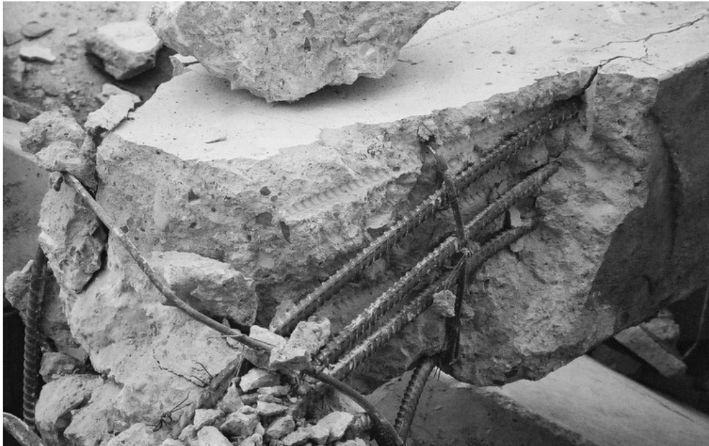
Rys. 6 Widok złamanego słupa.
