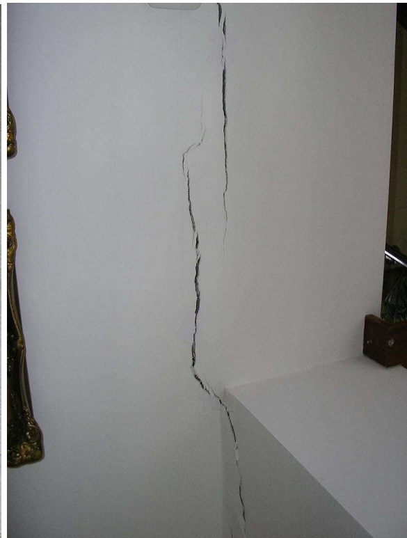
Rys. 4 Zarysowanie ściany pomiędzy łącznikiem a częścią mieszkalną.
