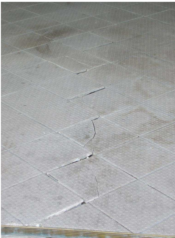
Rys. 3 Pęknięcie podłogi w garażu
