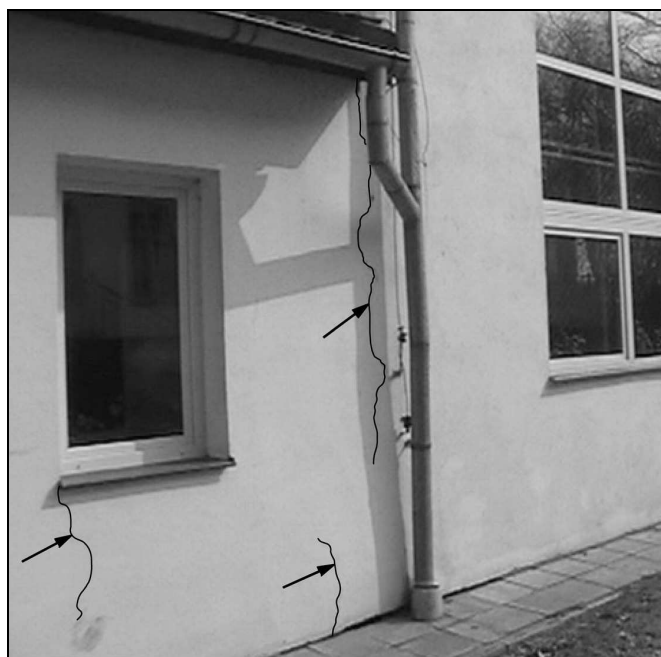
Rys. 3. Spękania ściany zewnętrznej sali gimnastycznej.
