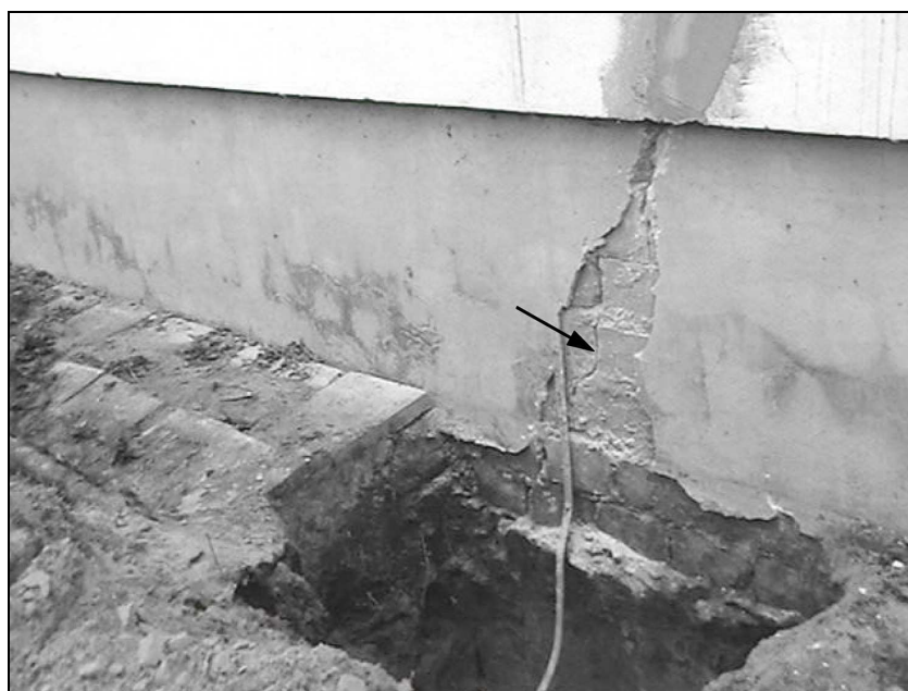
Rys. 4. Uszkodzeniu uległy również fundamenty. Widok odkrywki fundamentowej. Wyraźne pęknięcie sięgające spodu fundamentów.
