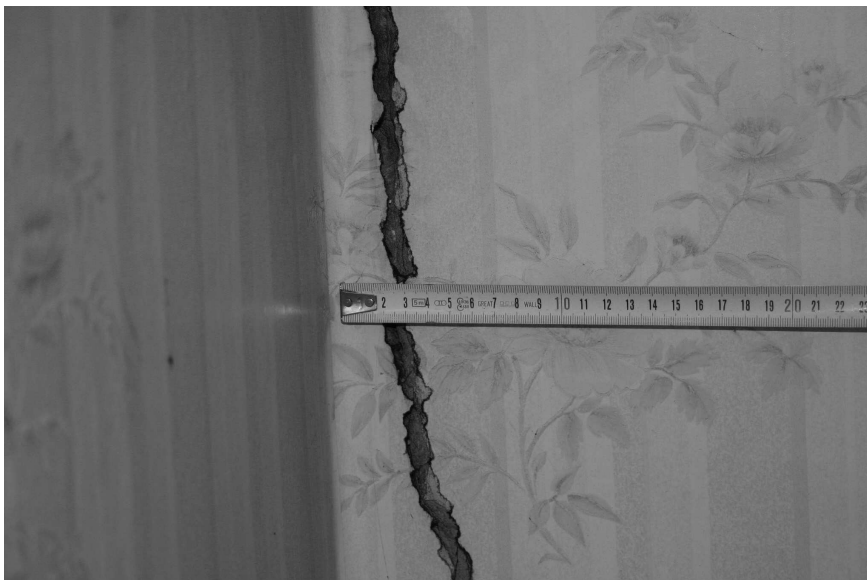
Fot. 3. Rysa w ścianie zewnętrznej w poziomie I piętra (oś 6/D-E).
