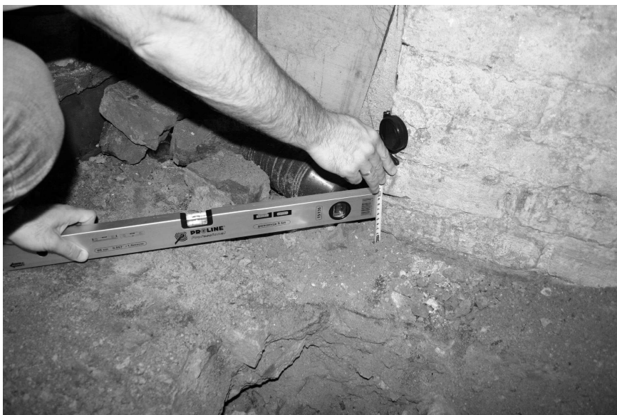
Fot. 4. Osiadanie filara w piwnicy – obok odkrywka (oś B/4-5).
