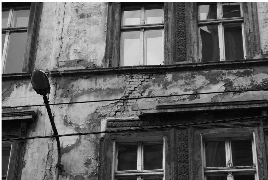
Fot. 1. Zarysowanie pasma podokiennego w ścianie elewacyjnej (w osi A/2-3).
