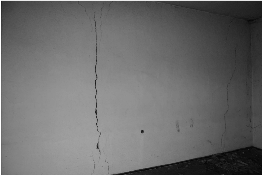
Fot. 2. Zarysowanie ściany w zewnętrznej w poziomie II piętra (osie 6/D-E – przejście budynku w oficynę).
