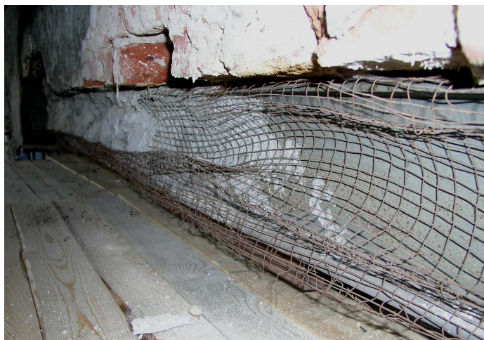
Rys. 4. Widok nadproża z luźnymi cegłami nad stalowymi belkami
