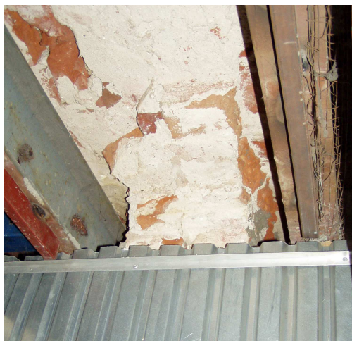
Rys. 3. Osadzenie belek nadprożowych w gniazdach muru bez zabezpieczenia przed ich obrotem wokół osi podłużnej
