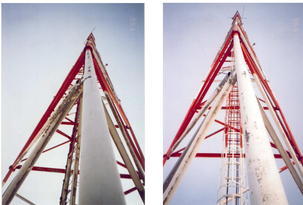
Rys. 5. Wykrzywione krawężniki wieży „a-2”
