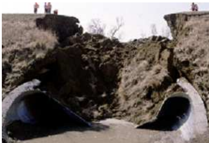
Rys. 11. Katastrofa konstrukcji podatnej z blach falistych (USA).
