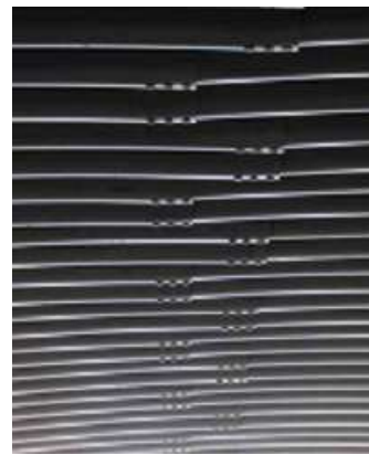
Rys. 9. Uszkodzenie złączy śrubowych połączone z lokalnym uplastycznieniem ścianki konstrukcji wskutek lokalnego obciążenia nie zasypanej konstrukcji wysoką pryzmą kruszywa
