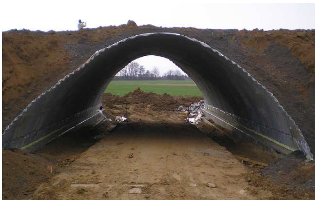
Rys. 8. Deformacja konstrukcji z blach falistych wskutek niewłaściwego zagęszczania zasypki gruntowej wokół konstrukcji
