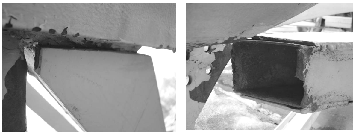
Rys. 7. Wzmocnienie krzyżulców głównych podciągów w 2002 r.
