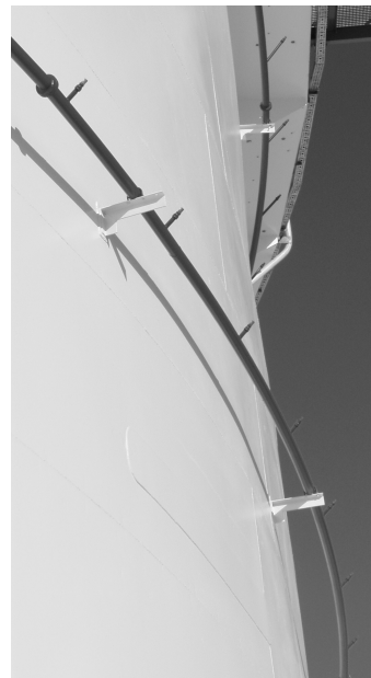
Rys. 3. Deformacje płaszczu zbiornika na dziesiątym i jedenastym jego pierścieniu
