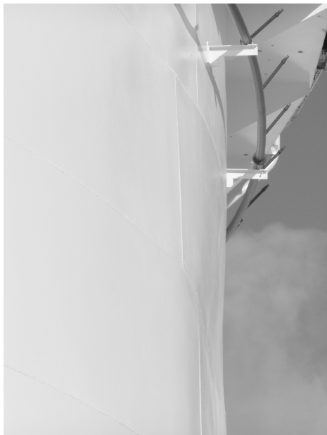
Rys. 2. Deformacje płaszczu zbiornika na ósmym i dziewiątym jego pierścieniu
