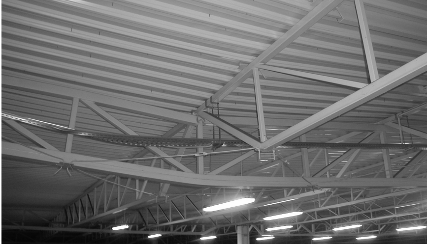
Rys.3. Charakter uszkodzenia dźwigara głównego nawy bocznej
