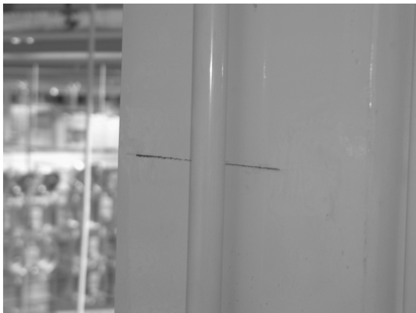
Rys. 3. Obserwowane z zewnątrz pęknięcie ściany trzonu słupa.
