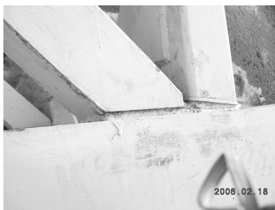
Rys. 7. Wzmocnienie krzyżulca (blacha wzmacniająca nie została połączona z pasem podciągu)
