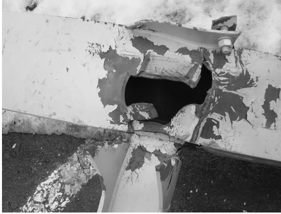
a) wyrwana ścianka pasa podciągu głównego
