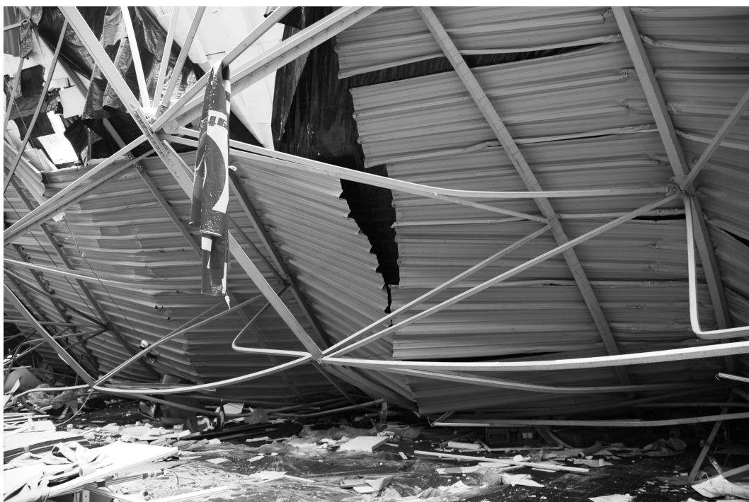
Rys. 9. Uszkodzenia blachy fałdowej i zastrzałów pseudo-struktury dachu
