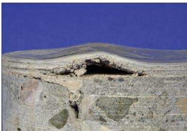
Rys. 9 Pęcherz wody i powietrza pod winylową wykładziną wylaną bezpośrednio na płycie betonowej
