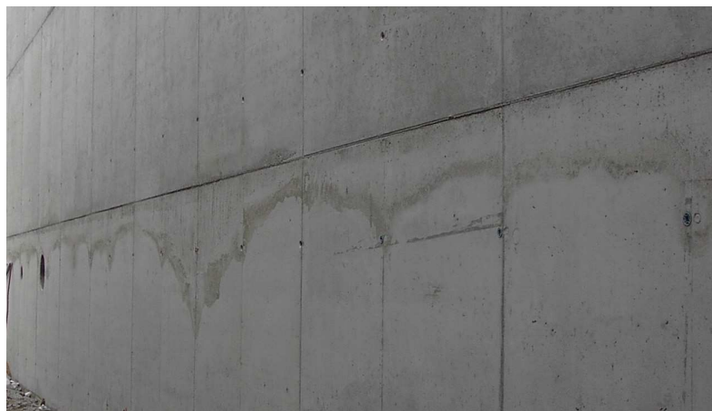
Rys. 5. Efekt „firanek” powstały w skutek betonowania w poziomych sekcjach i nie uwzględnienia skurczu dolnej warstwy
