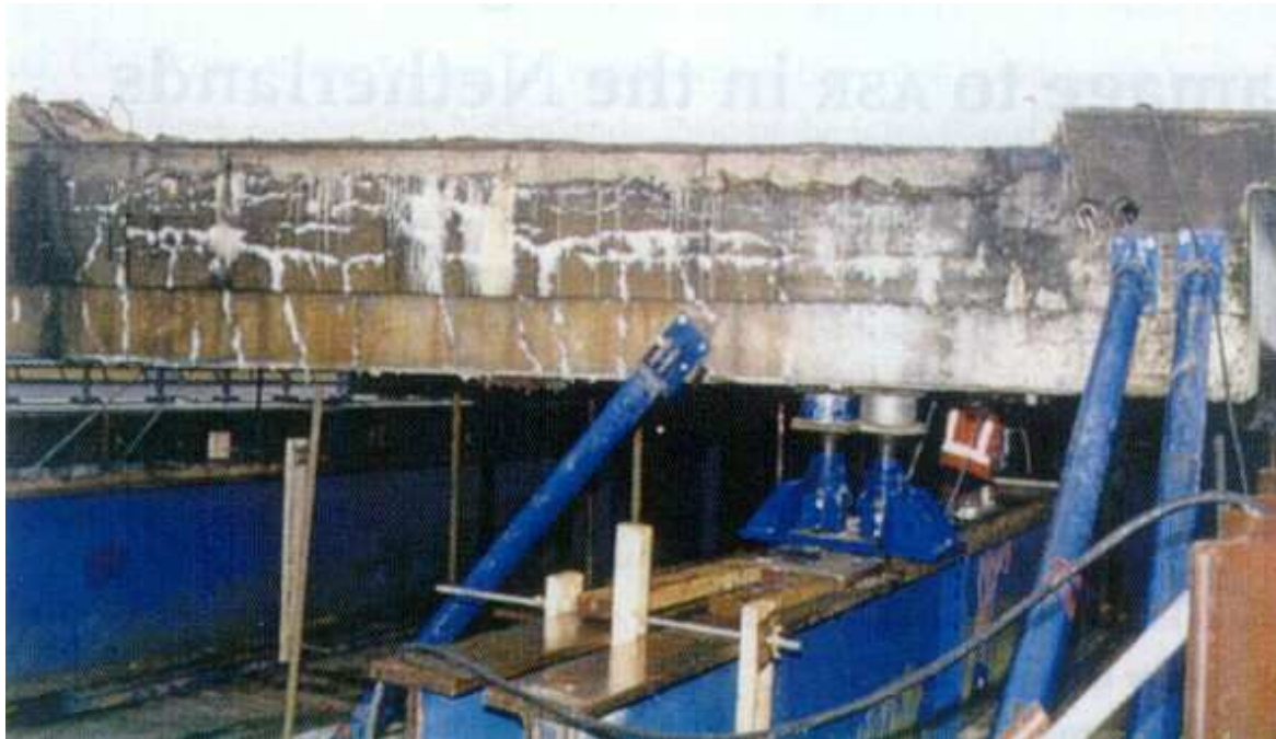
Rys. 8. Most w Holandii, typowy obraz betonu ulegającemu reakcji kruszyw z alkali
