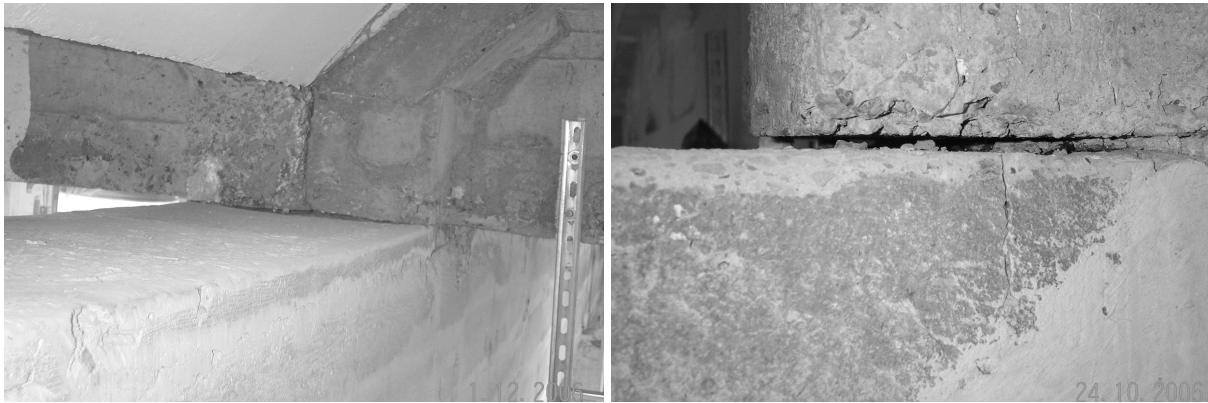
Rys. 3. Brak odpowiedniej strefy docisku podczas aplikacji obciążenia z dźwigara dachowego na rygiel
