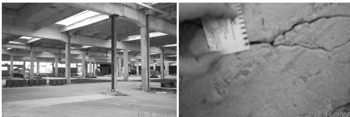
Rys. 1. Obraz ogólny konstrukcji nośnej dachu przed remontem, spękania, uszkodzenia, liczne zarysowania
