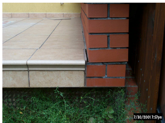
Rys. 10 Skutki braku dylatacji
