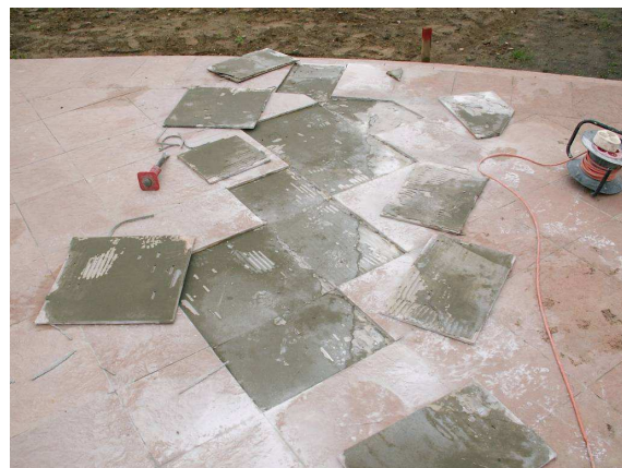
Rys. 8 Odpadanie płytek na tarasie – brak dylatacji
