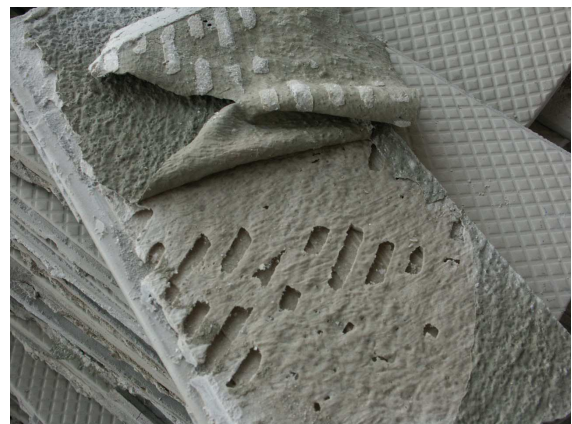
Rys. 6 Płytki odrywające się razem z uszczelnieniem od zbyt słabego podłoża.
