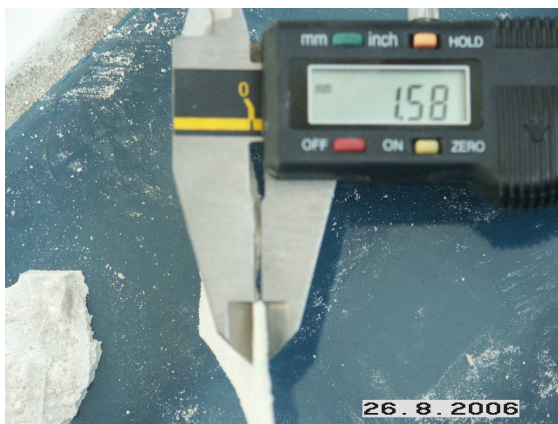
Rys. 5 Zbyt cienkie uszczelnienie
