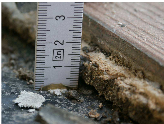
Rys. 3 Zbyt cienka warstwa podkładu na warstwie oddzielającej
