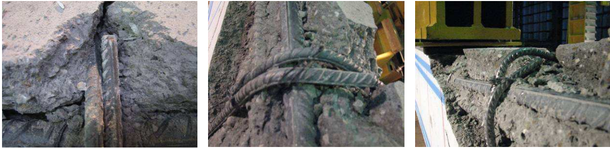
Rys. 9. Zniszczenie elementu ze stalą SI
