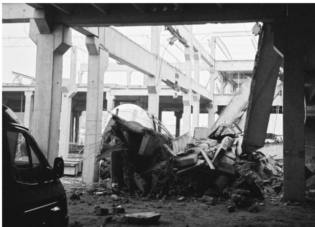
Rys. 4. Katastrofa budynku centrum handlowego w Szczecinie 2000 r.
