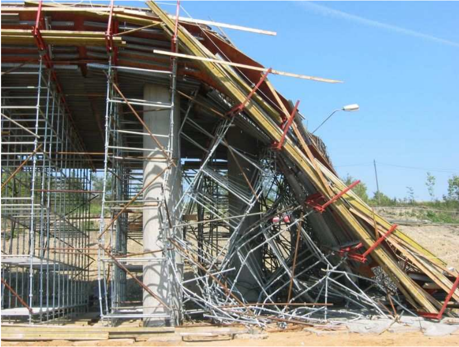
Rys. 7. Przykład katastrofy budowlanej rusztowań podporowych w Polsce
