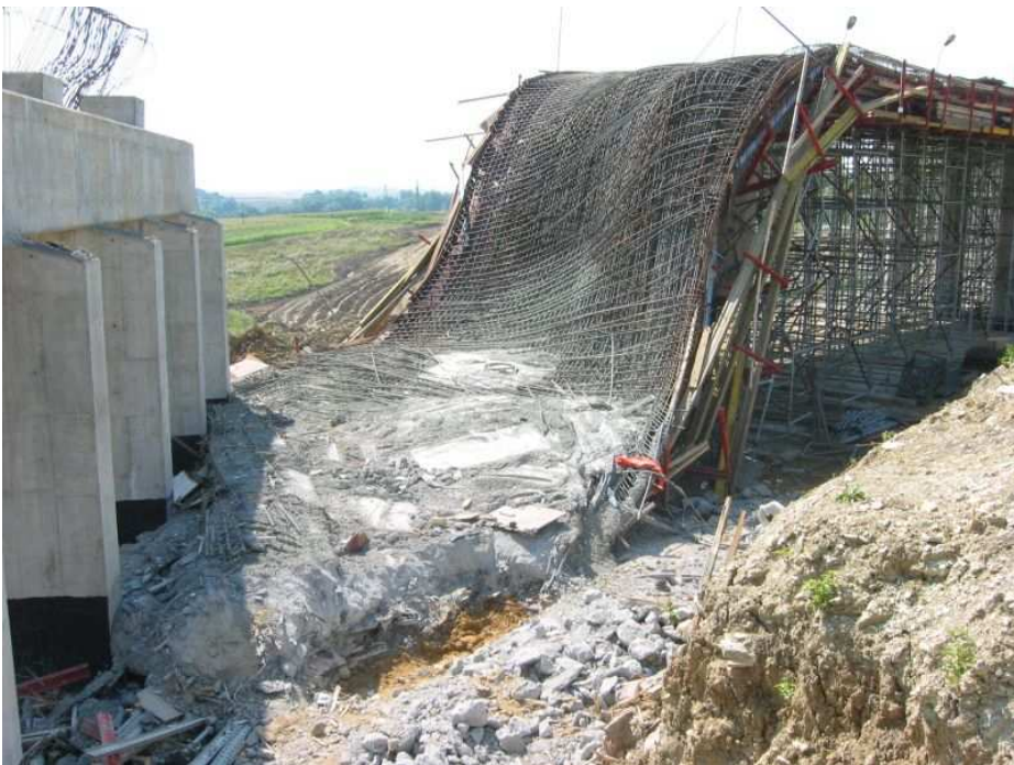
Rys. 8. Przykład katastrofy budowlanej rusztowań podporowych w Polsce
