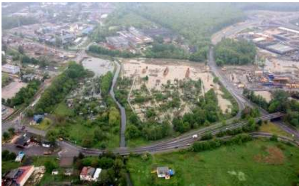
Fot. 4. Budowa A1 od węzła „Sośnica” do węzła „Maciejów” odcinek od km 512+530 do km 513+000 (budowa estakady WA-458)
