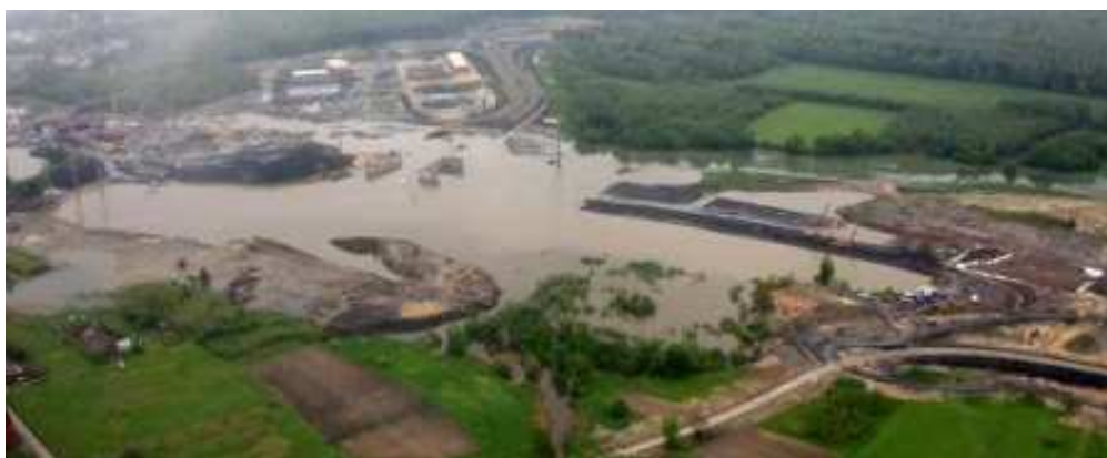
Fot. 2. Budowa A1 od węzła „Sośnica” do węzła „Maciejów” odcinek od km 511+600 do km 512+530 (w tym wiadukt WA-457 w km 512+183)
