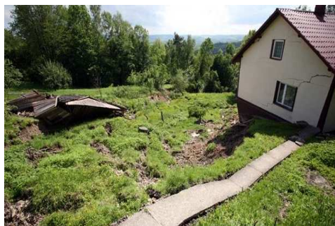
Rys. 4. Osuwisko w Lanckoronie
