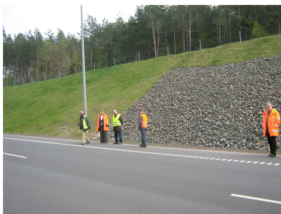
Rys. 23. Zbocze wykopu zniszczonego głęboką erozją zabezpieczone narzutem kamiennym
