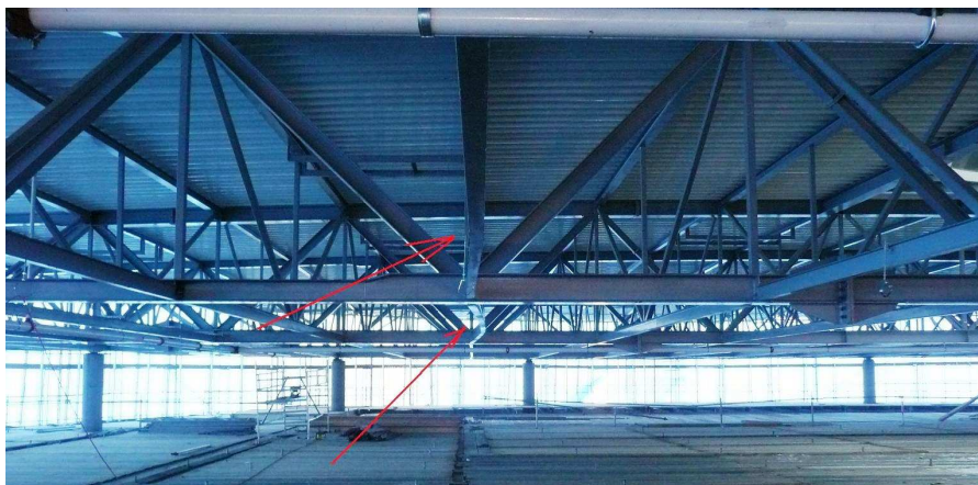
Rys. 4. Środkowa część konstrukcji z widocznymi odkształceniami pasów dolnych płatwi kratowej pomiędzy osiami 8 i 9 oraz E i F
