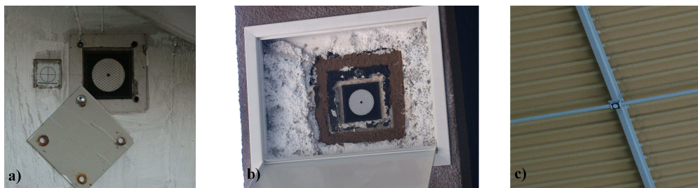
Rys. 4. Sygnały zamontowane na obiekcie amfiteatru: a) przyczółku żelbetonowym, b) ścianie sceny – jako punkty odniesienia, c) w wybranym punkcie konstrukcji przekrycia – jako punkt kontrolowany
