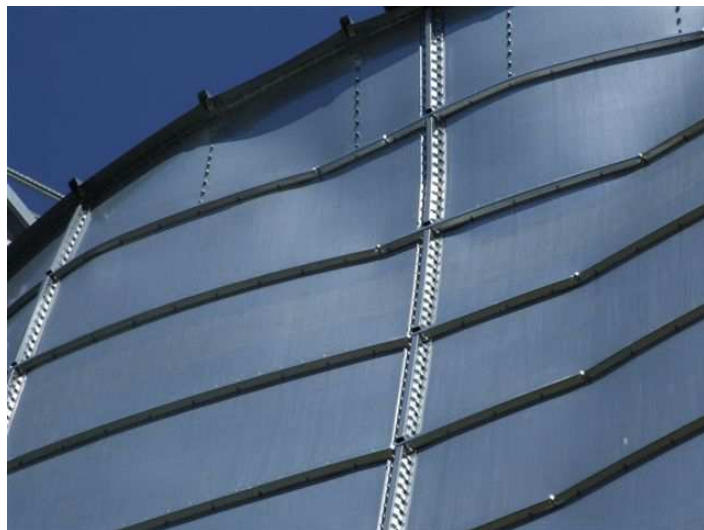
Fot. 1. Uszkodzona górna część silosu
