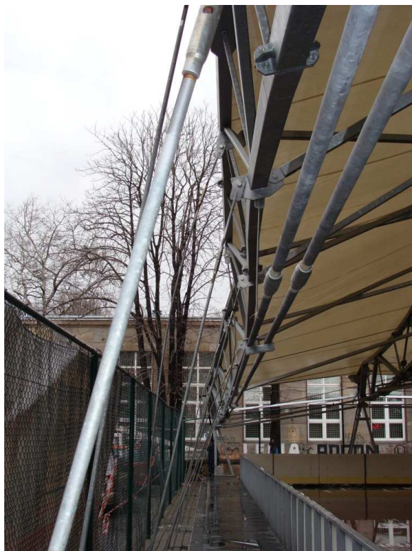
Rys. 4. Utrata stateczności skrajnego dźwigara kratowego konstrukcji od strony północnej
