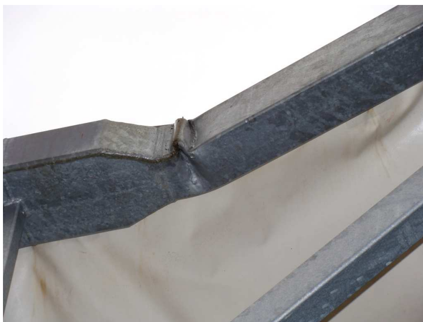
Rys. 6. Szczegół deformacji prętów pasa górnego skrajnego dźwigara od strony północnej
