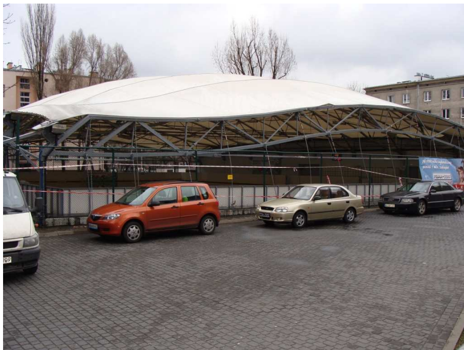
Rys. 2. Widok ogólny konstrukcji i skrajnego dźwigara przekrycia lodowiska od strony północnej po wystąpieniu awarii
