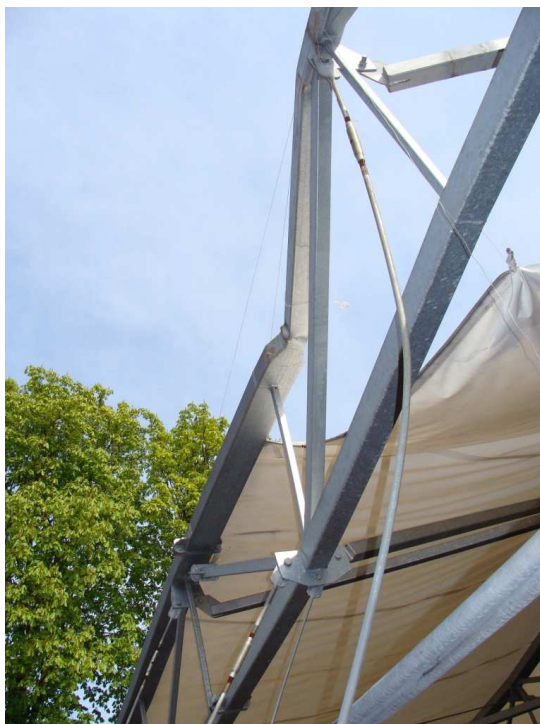
Rys. 5. Postać lokalnego wyboczenia pasa górnego skrajnego dźwigara od strony północnej
