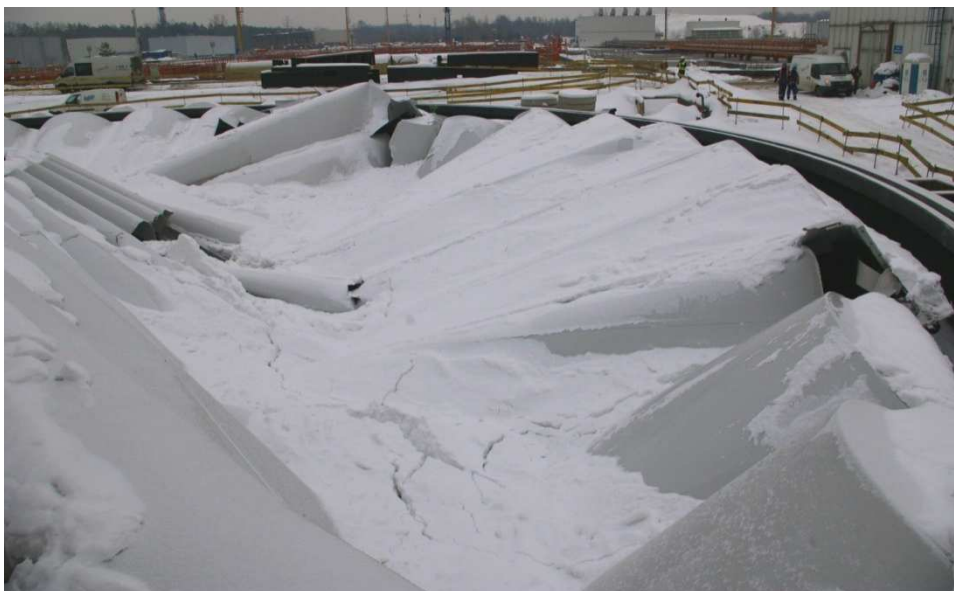
Rys. 7. Widok przekrycia łupinowego osadnika wstępnego po awarii
