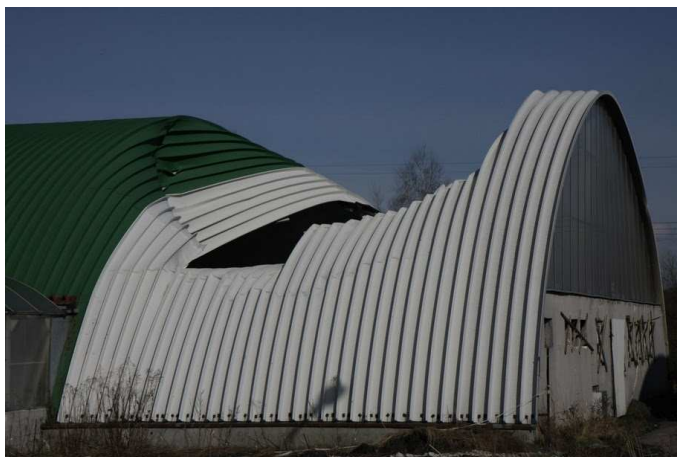
Fot. 2 Uszkodzenie przekrycia łukowego z blachy profilowanej
