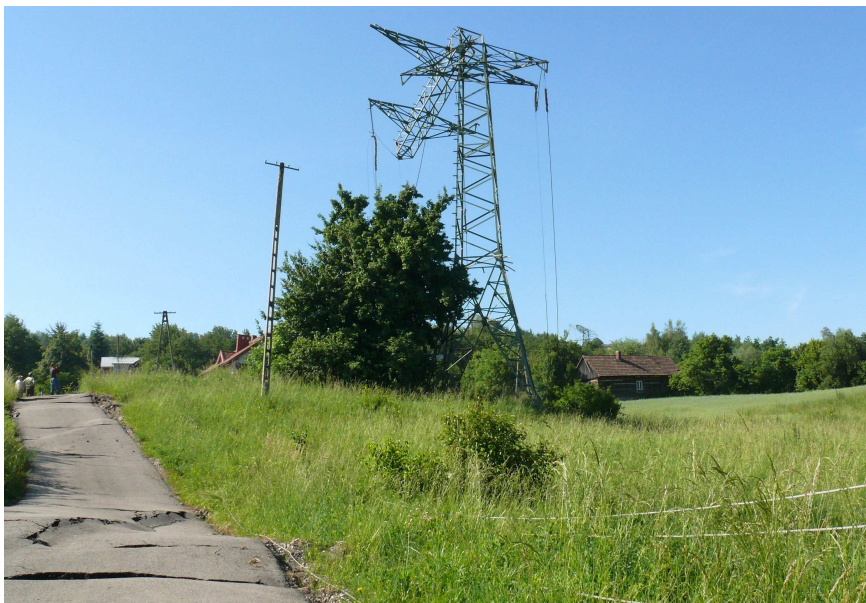
Rys. 1. Zniszczony słup nr 34, obok zniszczona droga
