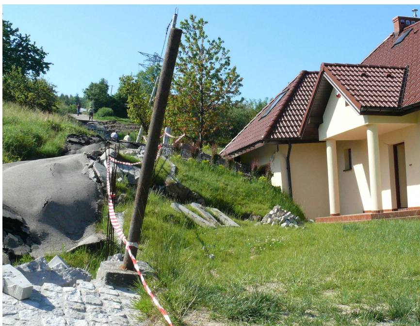
Rys. 2. Przemieszczenia mas ziemnych w pobliżu budynku (zasypany wjazd do garażu), zniszczona droga
