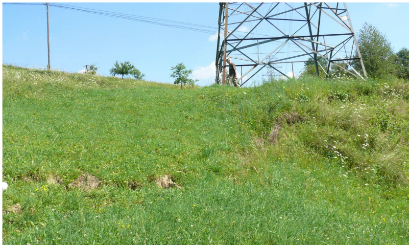
Rys. 5. Widok na słup z początkami zjawisk osuwiskowych
