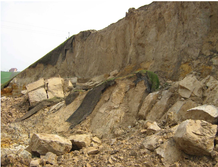
Rys. 4. Spękania gruntu – obrywy
