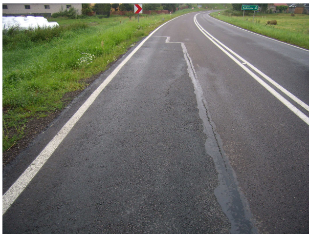
Rys. 3. Stan zniszczenia drogi na badanym odcinku km 84+050. Zniszczenie nawierzchni po zakończonej naprawie
