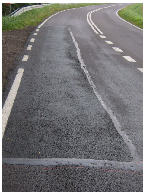
Rys. 4. Stan zniszczenia drogi w krótkim czasie po przeprowadzonym remoncie, km 83+180. Zniszczenie konstrukcji nawierzchni w miejscu połączenia korpusu drogowego z nasypem drogi gospodarczej
