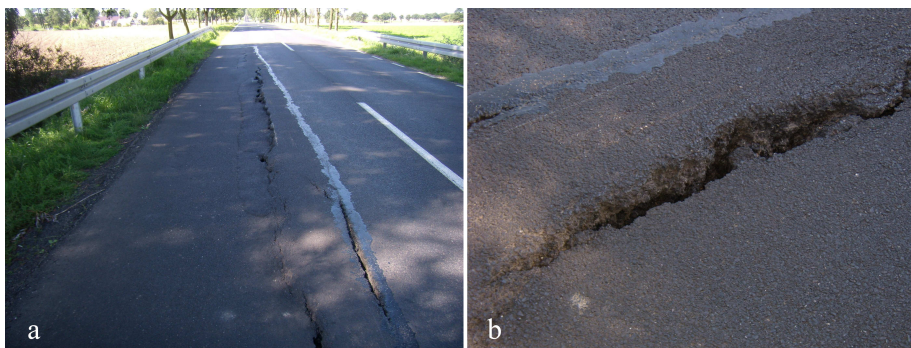
Rys. 2. Stan zniszczenia drogi na badanym odcinku km 81+820; a) pęknięcie konstrukcji nawierzchni, b) widok zniszczenia konstrukcji nawierzchni asfaltowej
