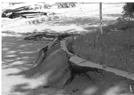
Rys. 6. Uszkodzona nawierzchnia asfaltowa po południowo – zachodniej stronie hali
