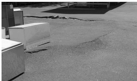
Rys. 5. Uszkodzona nawierzchnia asfaltowa po południowej stronie hali
