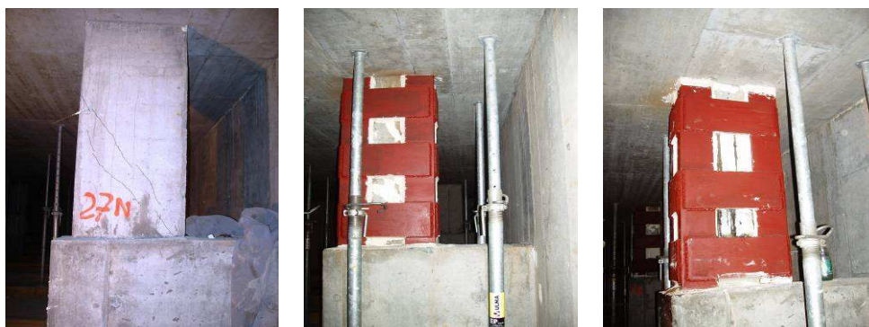
Rys. 7. Ukośne zarysowanie słupów i wzmocnienie stalowymi gorsetami
