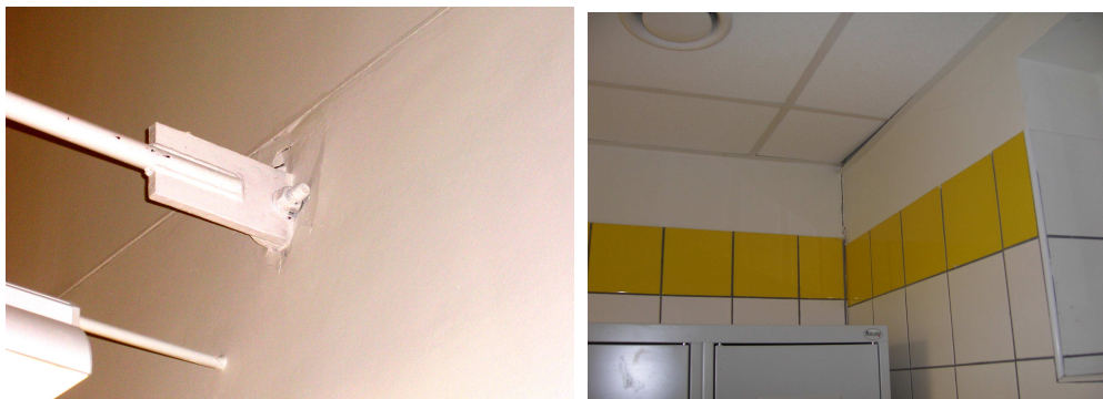
Rys. 3. Uszkodzenia konstrukcji obiektu handlowego
